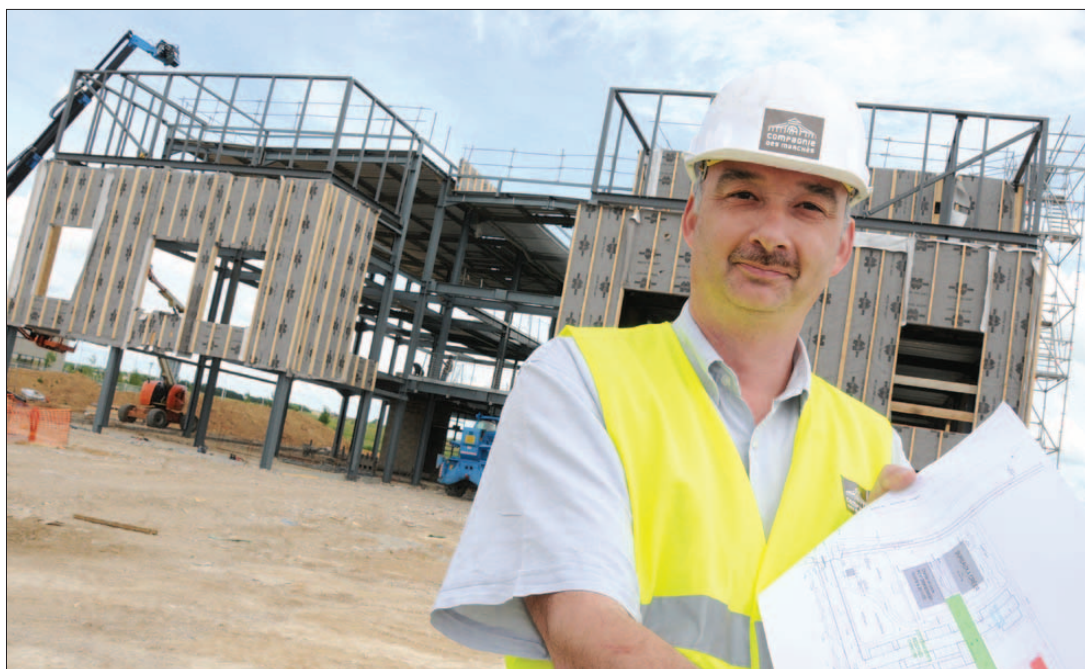
Chartres, hier. Le siège social de La Compagnie des marchés est en cours de construction dans le jardin d'entreprises (photo Anne-Sophie Pichard).
